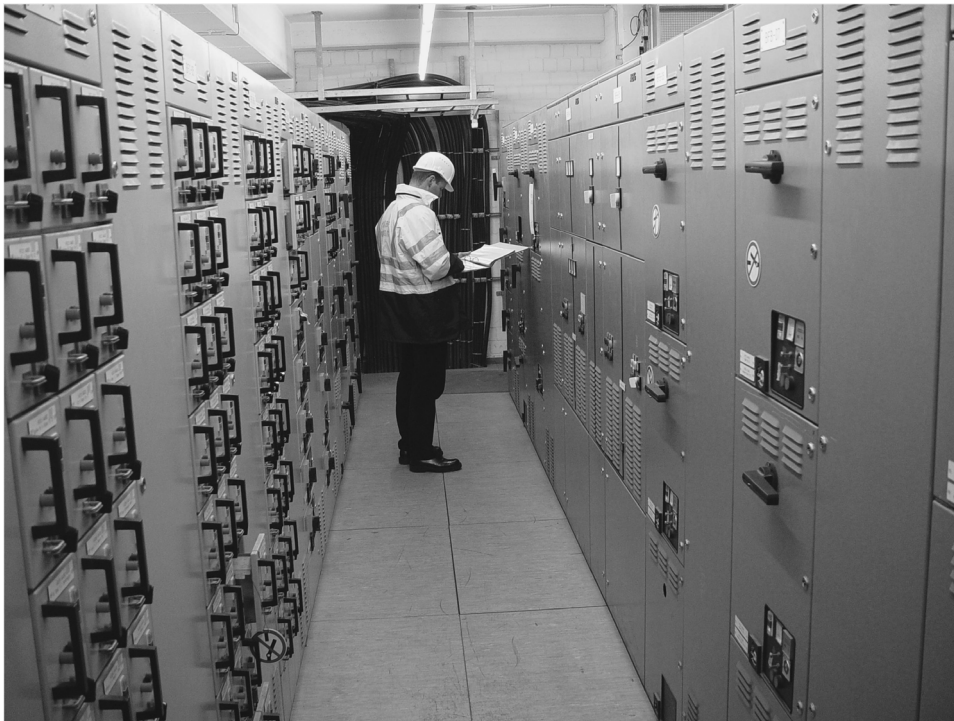
Abbildung 25: Beispiel für eine Energieverteilungsanlage
