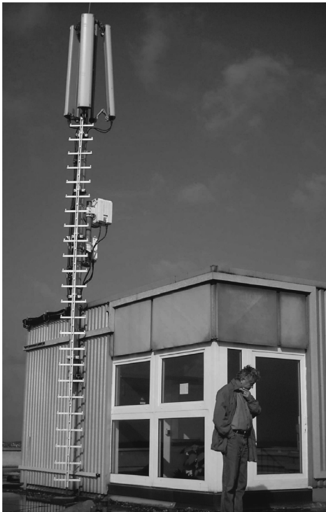
Abbildung 27: Sendefunkanlagen für den Mobilfunk
