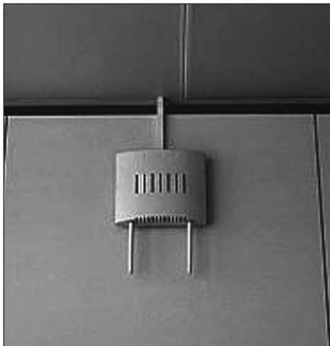
Abbildung 26: Access Point für DECT-(Digital Enhanced Cordless Telecommunications)-Anlagen
